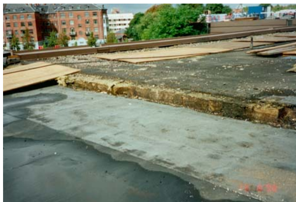
I varme tage som ikke bliver vlligeholdt er der risiko for opfugtning af isoleringen, som da må fjernes. På Panuminstituttet i København er der fjernet 5000 m 2 tagisolering i forbindelse med reoveringen i 1999.
