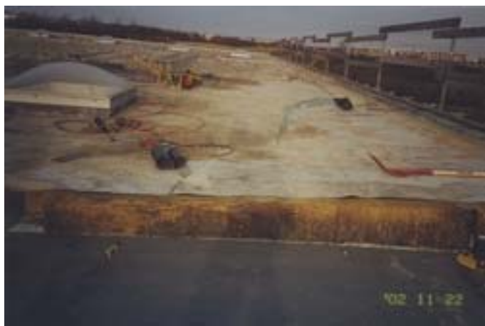
Våd isolering til udskiftning.
